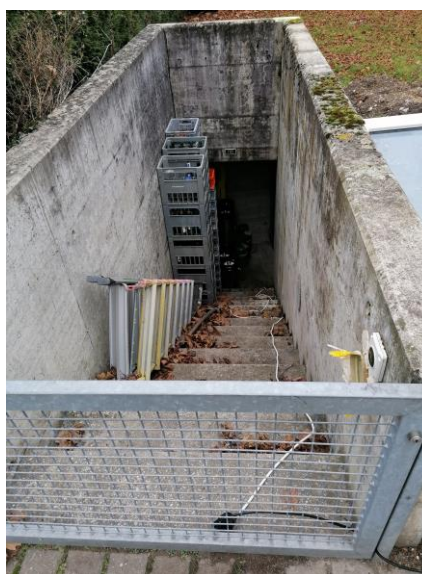
Accès vers le stock extérieur, non sécurisé contre les chutes
