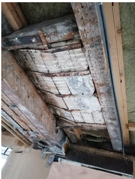
Trace d'un ancien foyer au plafond du restaurant
