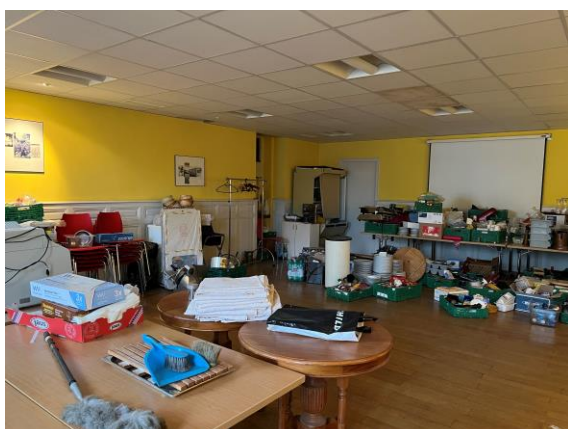
Traces d'infiltration d'eau et de moisissures au plafond de la salle de réunion
